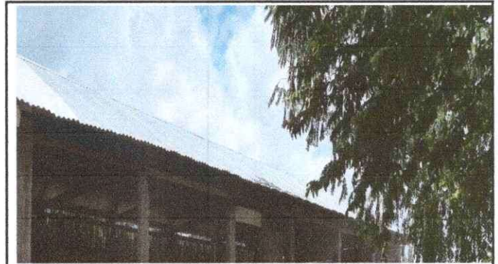
Foto 4: Se observa el deterioro de las laminas portantes
