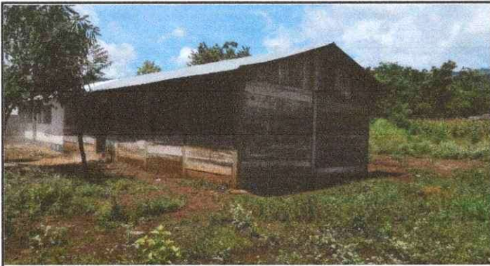
Foto 3: Se observa una de las aulas en mal estado
